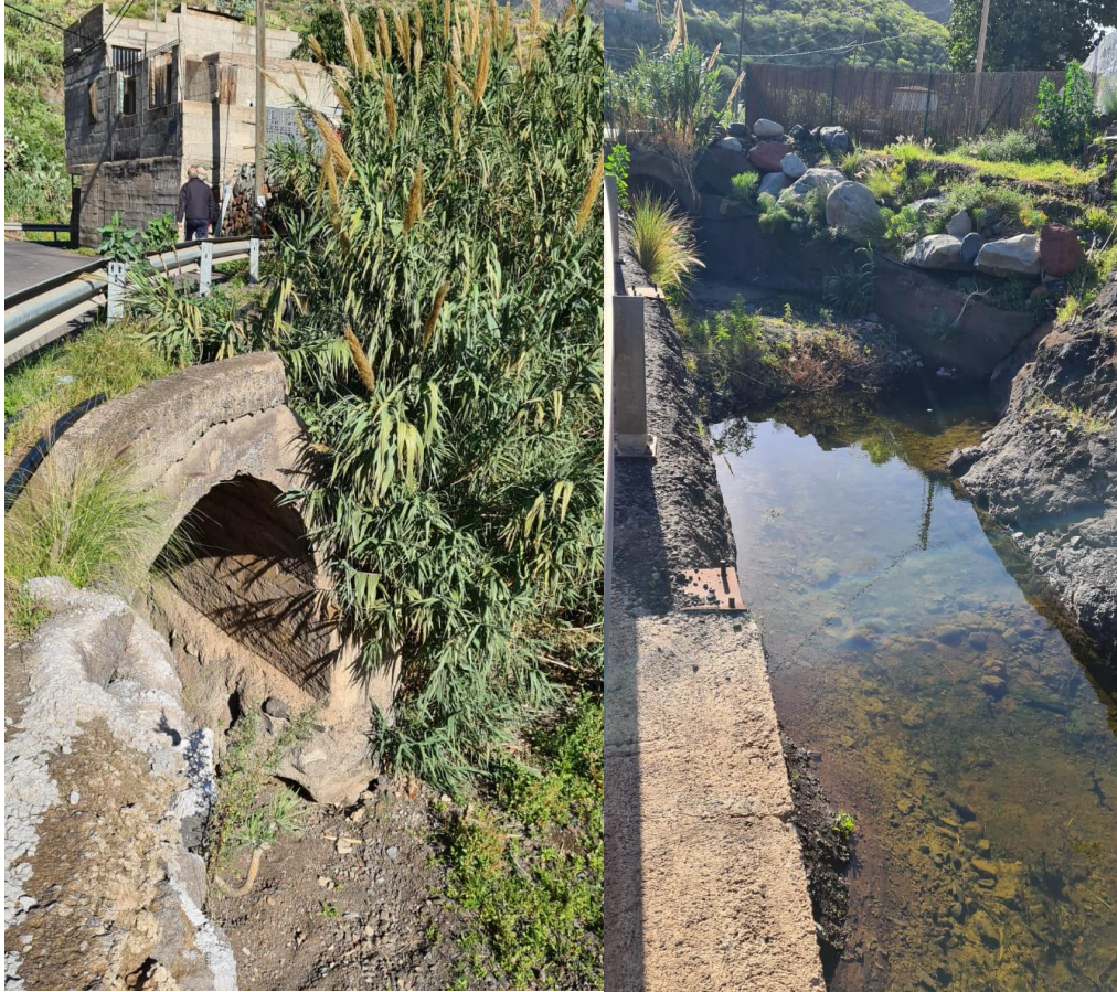
Fotografías 3 y 4. Vista del deficiente estado de la obra de paso actual aguas abajo y aguas arriba del cauce del barranco.
