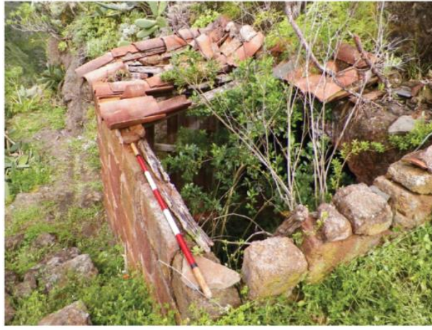
Fig. nº 21. Exterior de la gañanía, con la cubierta en estado de derrumbe
